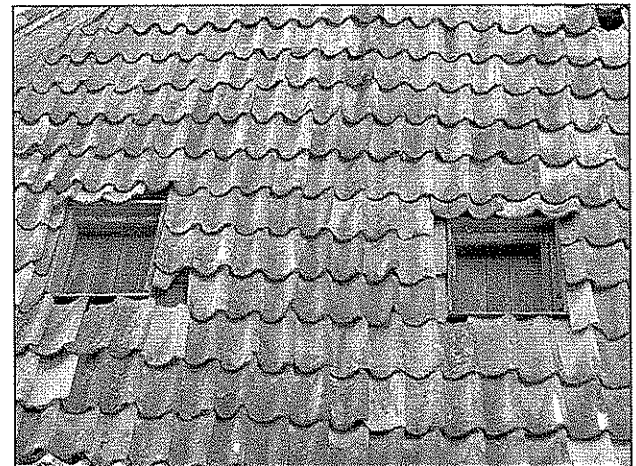
Defizite bei der Bauunterhaltung
