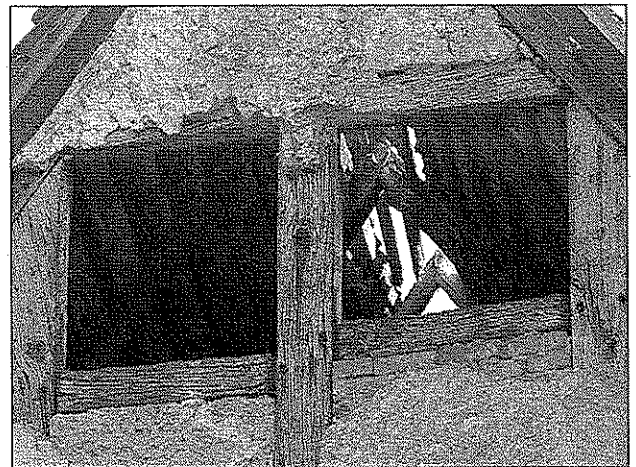
Zerfall historischer Bausubstanz
